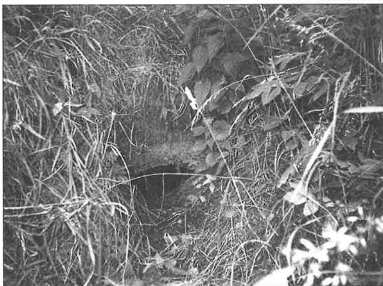
Fot. 3. Zamulony przewód rurowy przepustu na rowie zbiorczym
